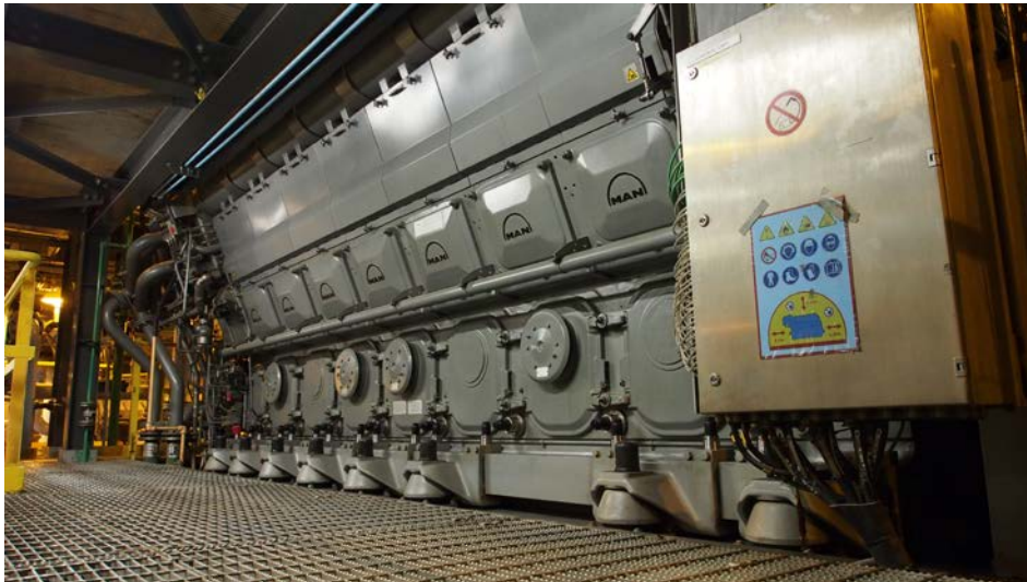
Drei Motoren vom Typ MAN 14 V32/40 CD stellen elektrischen Strom für die Prozesse der Raffinerie bereit.
